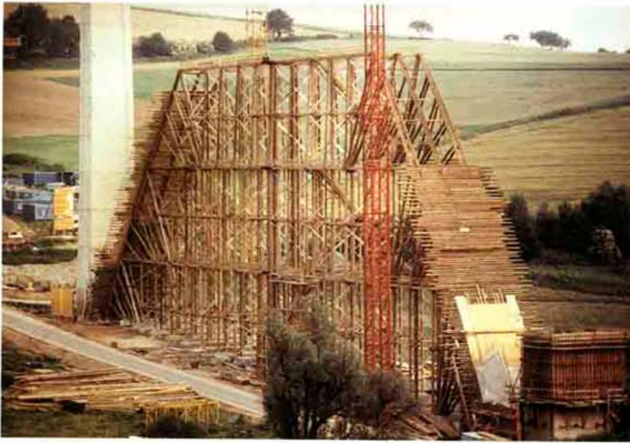
Bild 3: Lehrgerüst für die Mülmischtalbrücke der DB. Die Konstruktion mit Rundholz und Windrispenbändern entwickelte Rinn: 100 m lang, 60 m hoch und nur 7 m breit.
