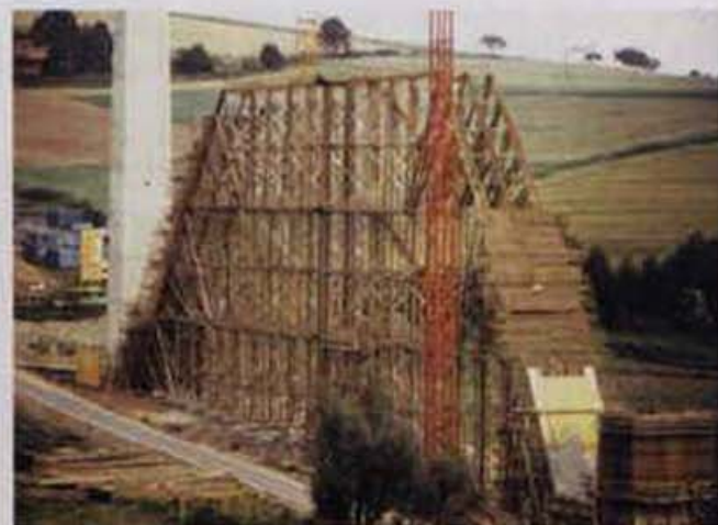
Bild 4: Mülmischtalbrücke bei Melsungen von 1988. Neubaustrecke der Deutschen Bundesbahn (NBS), 870 m lang, bis 70 m hoch, mit A-Bock als Festpunkt. Herstellung des A-Bocks auf Holzrüstung mit Querabspannung
