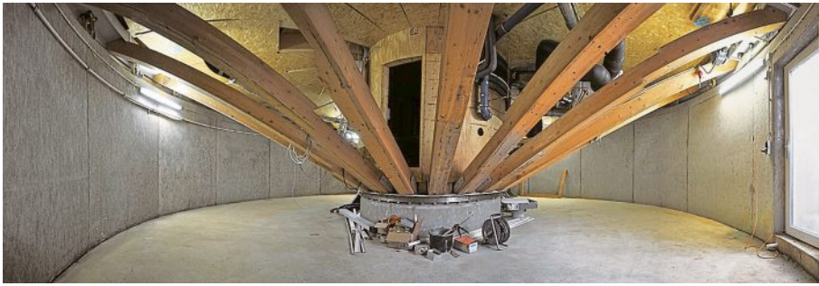
Im Kellergeschoss ist die Technik verborgen, die das Haus dreht. Das 150 t schwere Haus steht auf einer Bodenplatte, die wiederum auf einem hölzernen Drehkranz montiert ist.
